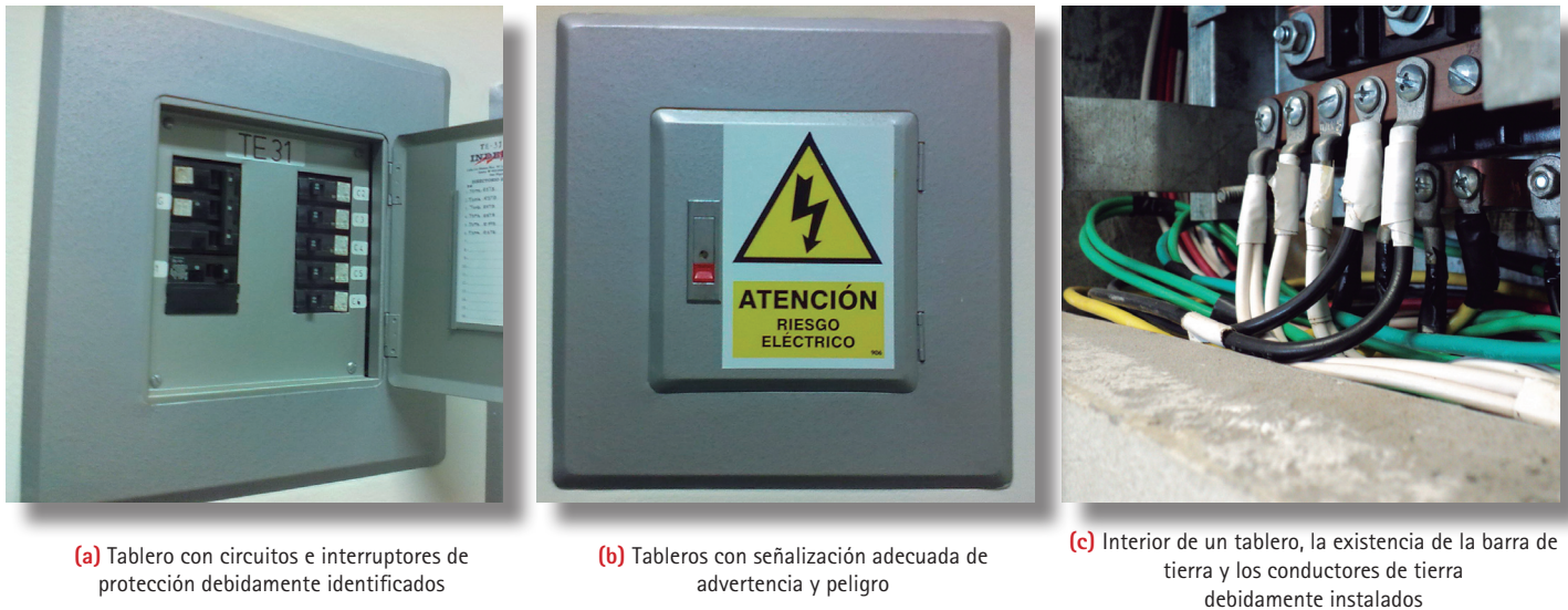
Figura 3 - Detalles de tableros eléctricos
