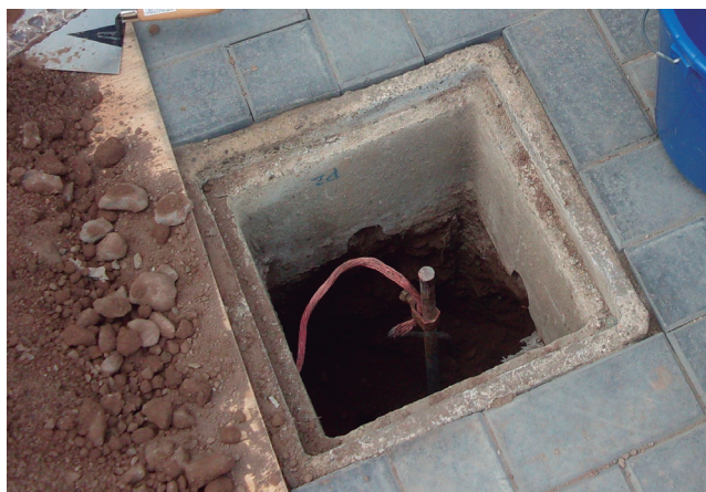
(b) Pozo de tierra en mantenimiento
